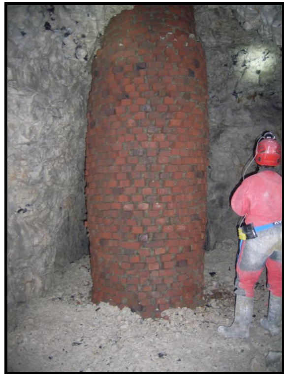
Photographie 5 : Gonflement du parement du puits P1 (Photo 254)
