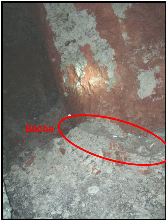
Photographie 8 : Bâche sous-dimensionnée se trouvant sur un monticule non arasé et sous un parement fracturé (photo 192)
