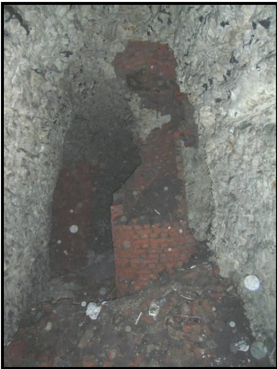
Photographie 4 : Effondrement de la colonne en briques du puits P3 (Photo 194)
