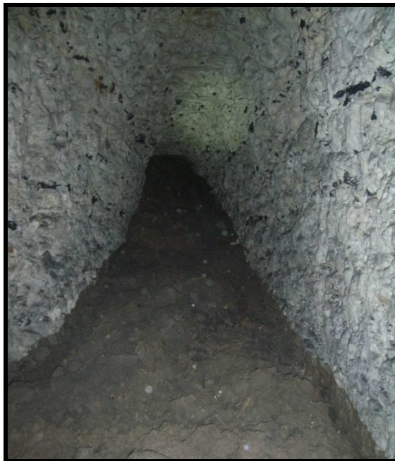
Photographie 3 : Coulée de terre visible suite au traitement en surface de l'effondrement de novembre 2010 (Photo 206)
